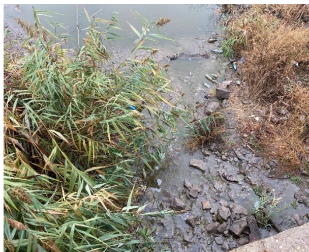
Foto 2. Râu Câlniștea - zona aval de podul de pe DN6 (E70) (imediat sub pod)
