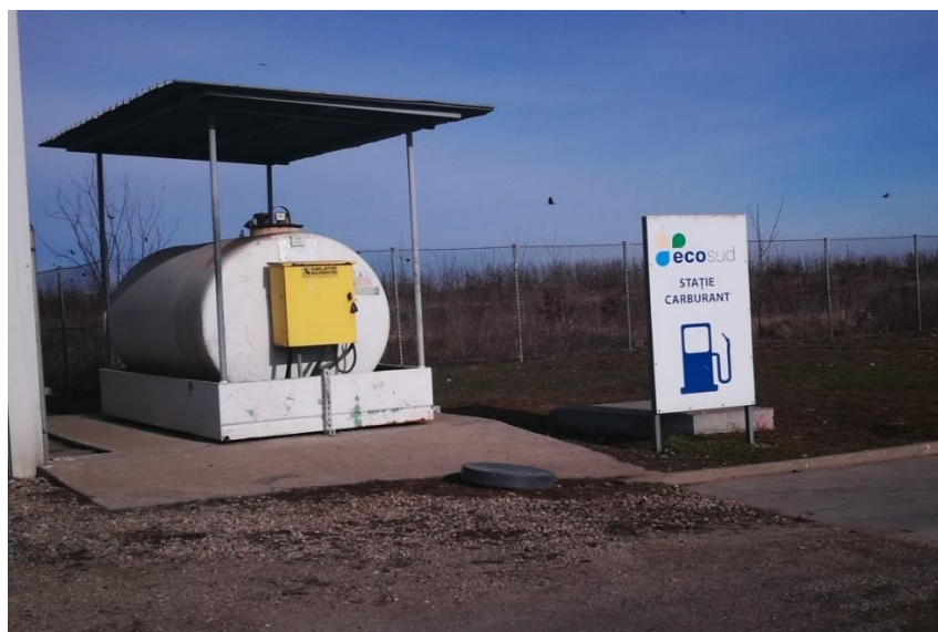
Foto 13 Rezervorul de motorină pentru alimentarea autoutilajelor din dotare
