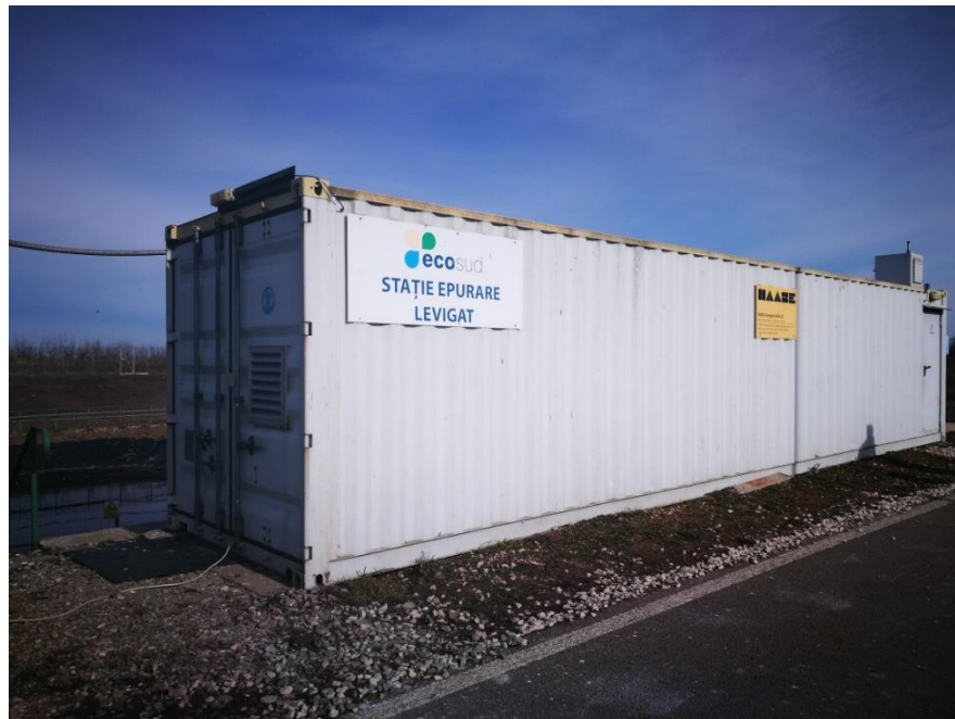
Foto 25 Stația de epurare
