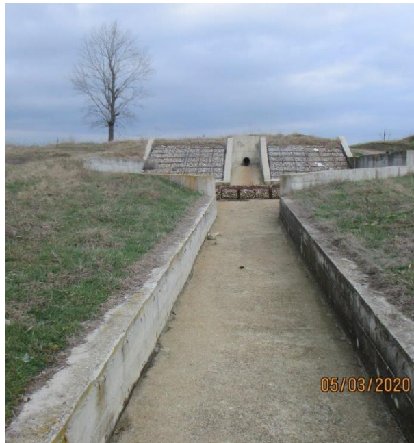
Foto 28 Evacuare ape uzate epurate în Pârâul Câinelui
