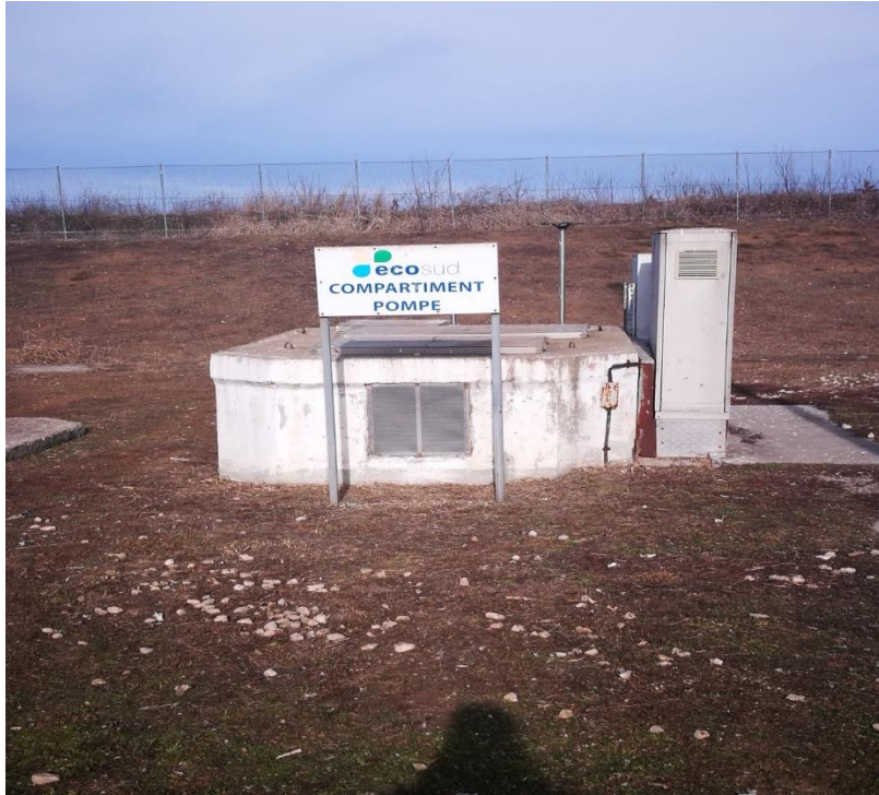
Foto 27 Stația de pompare a apei în pâraul Câinelui
