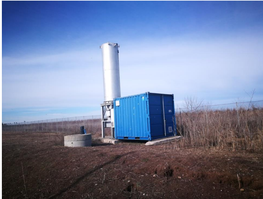
Foto 17 Stația de ardere biogaz / gaz de depozit
