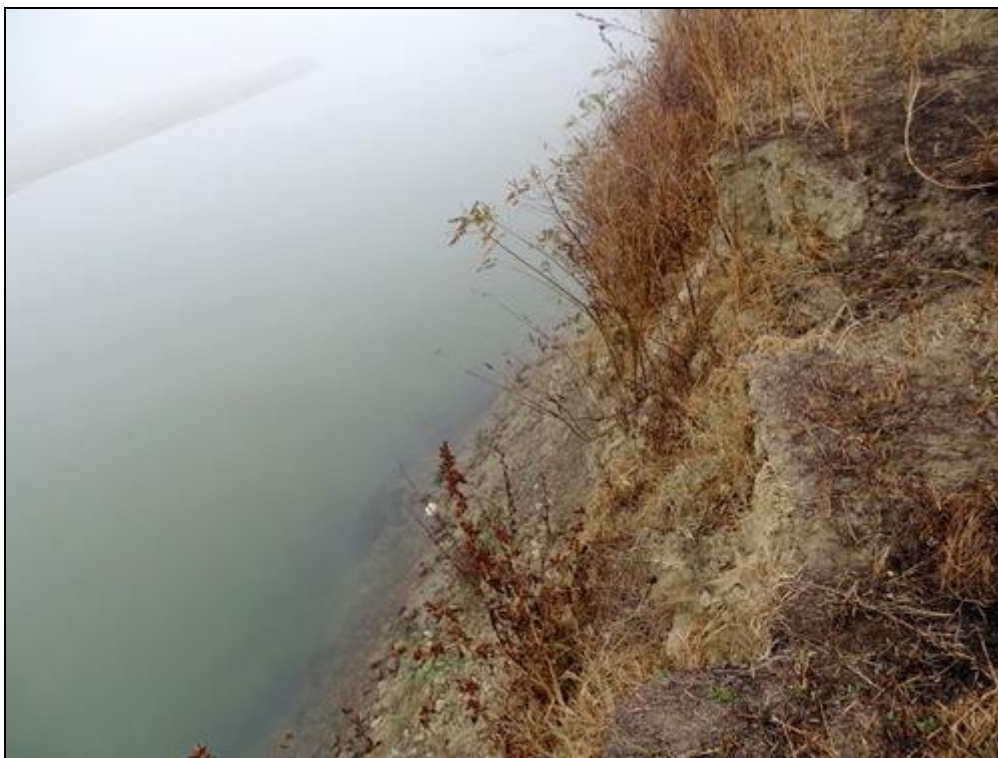
Figura nr. 64 – Aspect privind malul drept al Oltului în zona de amplasare a gurii de evacuare a conductei de evacuare
