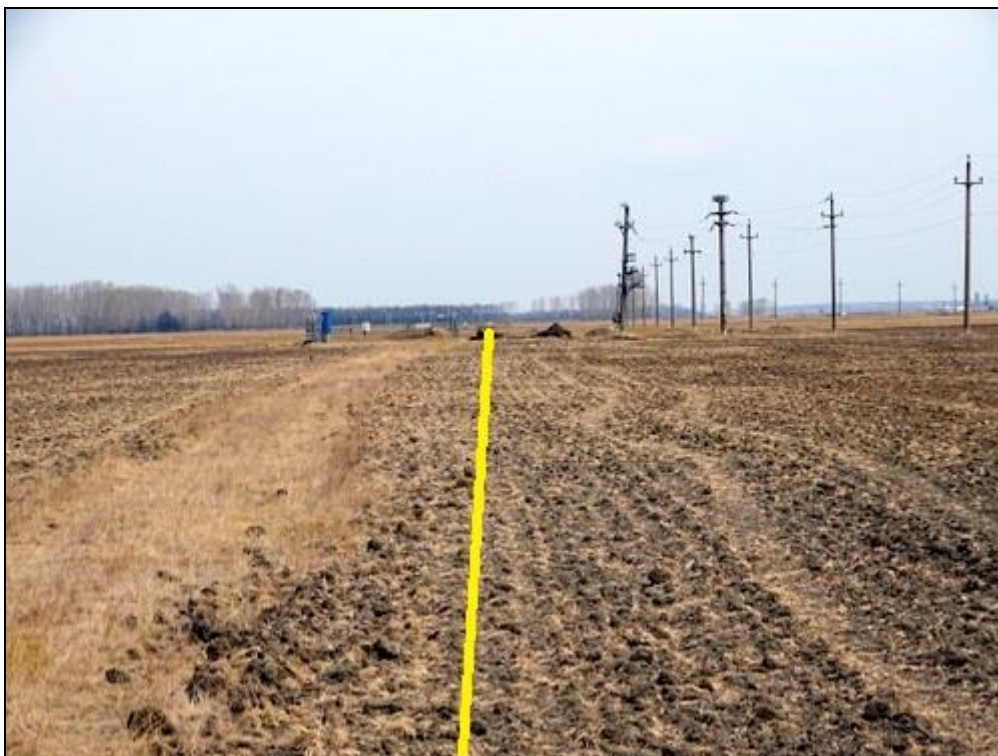
Figura nr. 25 – Aspect privind tronsonul de inlocuire conductă legătură puțuri între puțul nr. 23 și puțul nr. 22
